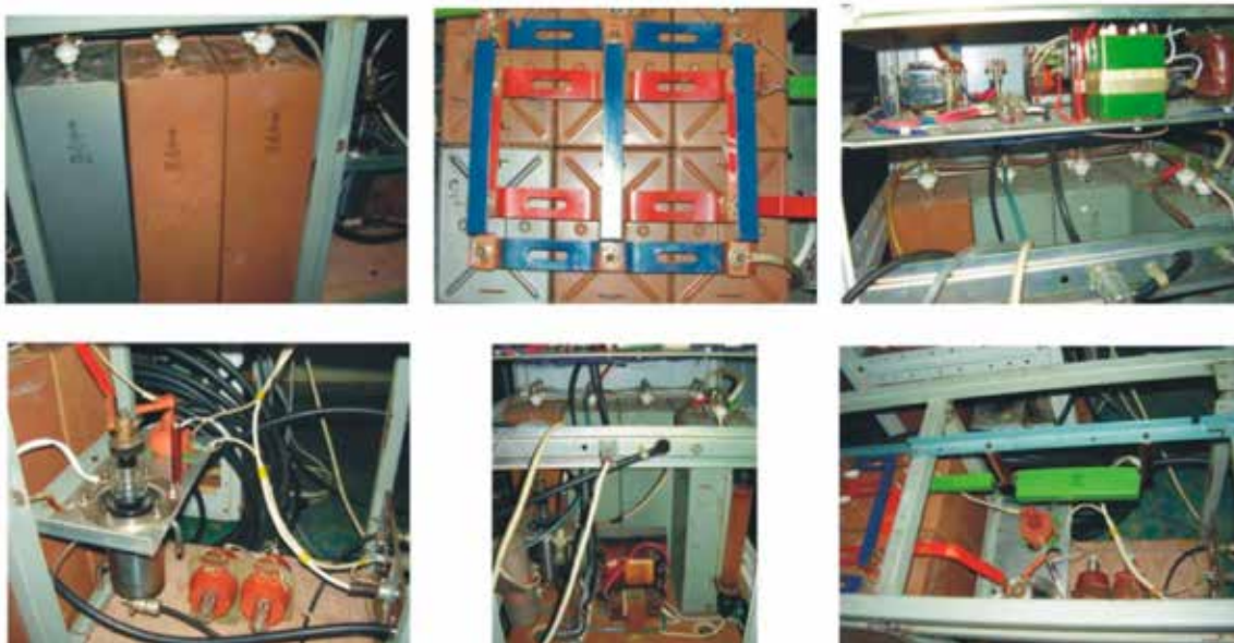
Рис. 8. Смонтированные узлы дополнительного второго блока двухканального варианта «Устройства» Fig. 8. Mounted units of the additional second two-channel unit version of the Device
