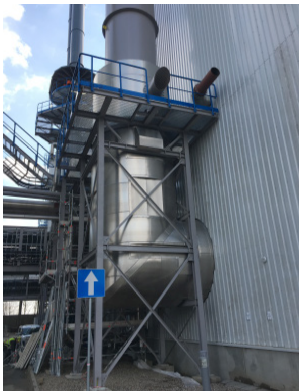
Ryc. 4. Widok przepustu rury z parą wodną \varnothing 2100 mm w obiekcie ITPOK w Poznaniu Fig. 4. View passage of steam pipe of 2100 mm in diameter in ITPOK facility in Poznan
