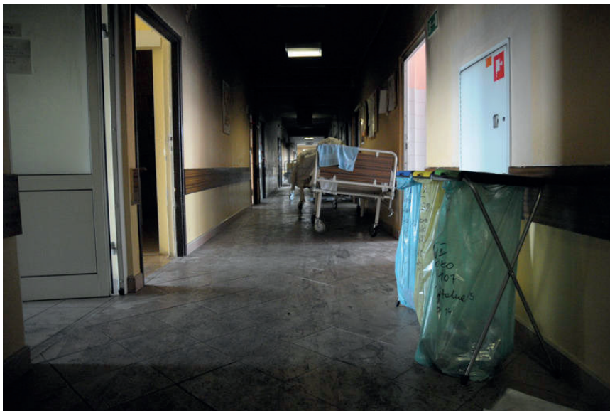
Ryc. 5. Widok korytarza po pożarze jednego z pokoi szpitalnych w Dąbrowie Górniczej [4] Fig. 5. View of the hall after a fire in one of the rooms of a hospital in Dąbrowa Górnicza [4]
